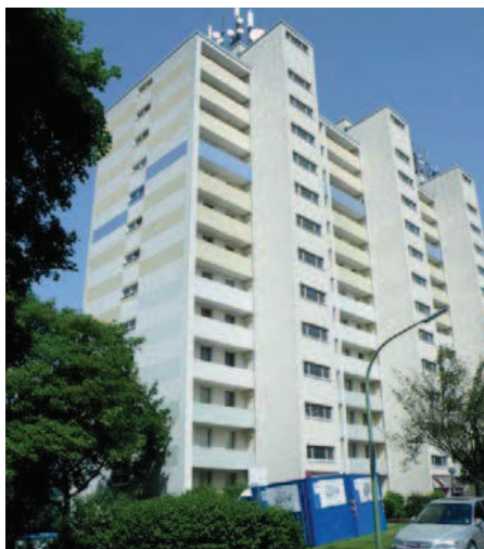
Die Bäder in diesem Hochhaus in der Niedernhofstraße in Hagen wurden im Mai modernisiert
