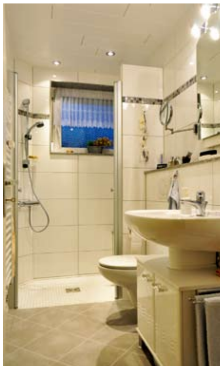
Eins der Bäder, das die Wilhelmshavener Spar- und Baugesellschaft in sieben Tagen saniert hat.
