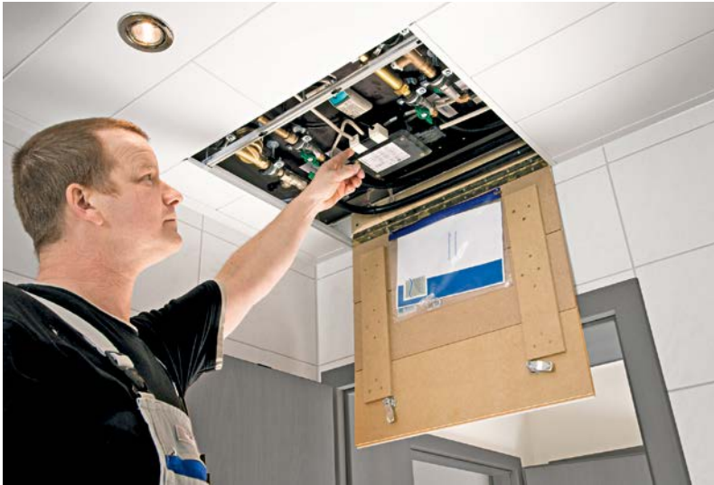
Der zentrale Anschlusspunkt: Unter der abgehängten Decke laufen alle Leitungen zusammen
