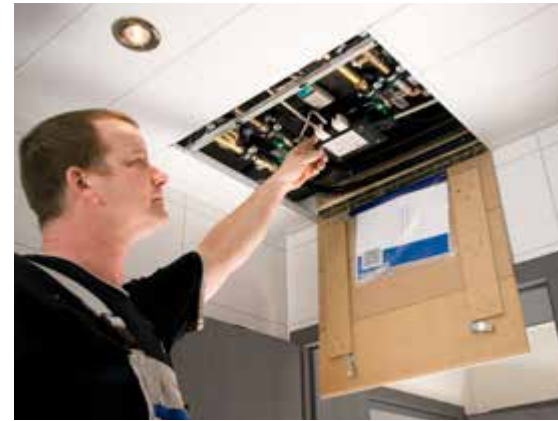
Der zentrale Anschlusspunkt: Unter der abgehängten Decke laufen alle Leitungen zusammen.
